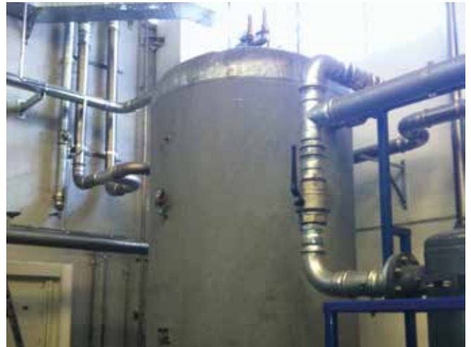
Serbatoio aria compressa
